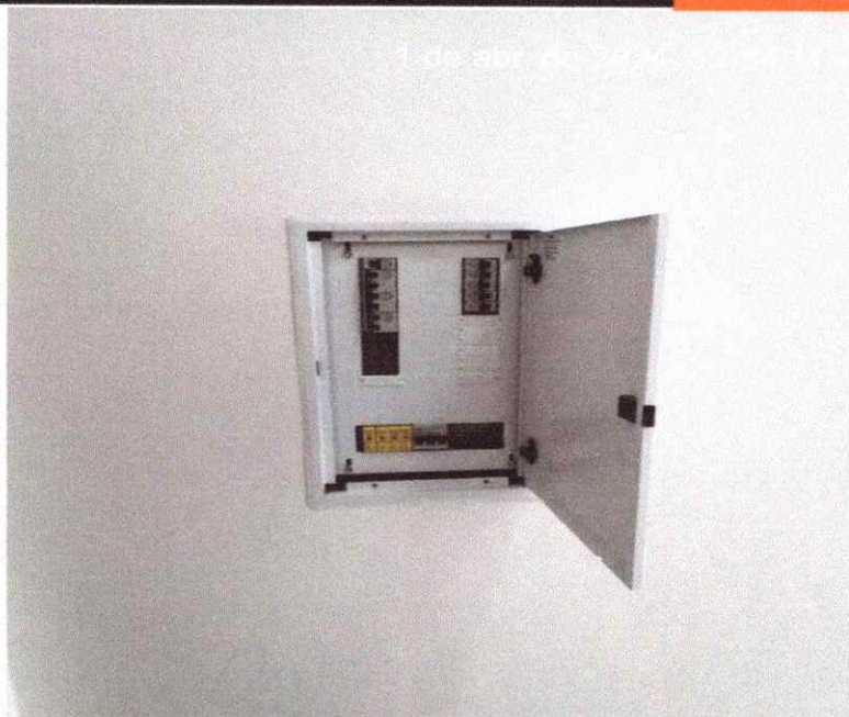
Figura 23: QUADRO DISTRIBUIÇÃO DA PARTE ADMINISTRATIVA
