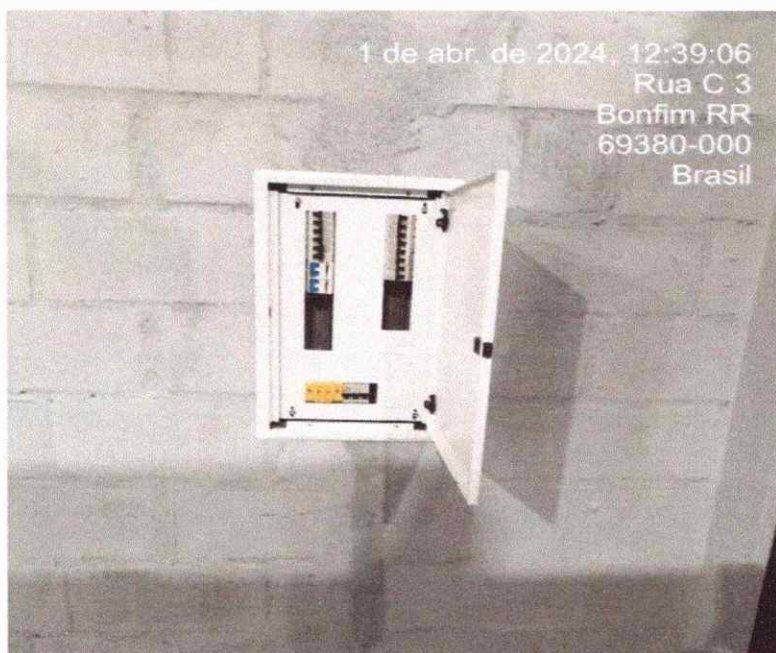
Figura 18: QUADRO DISTRIBUIÇÃO DO GALPÃO
